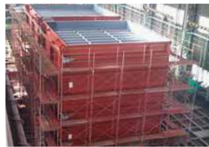
排気サイレンサー
